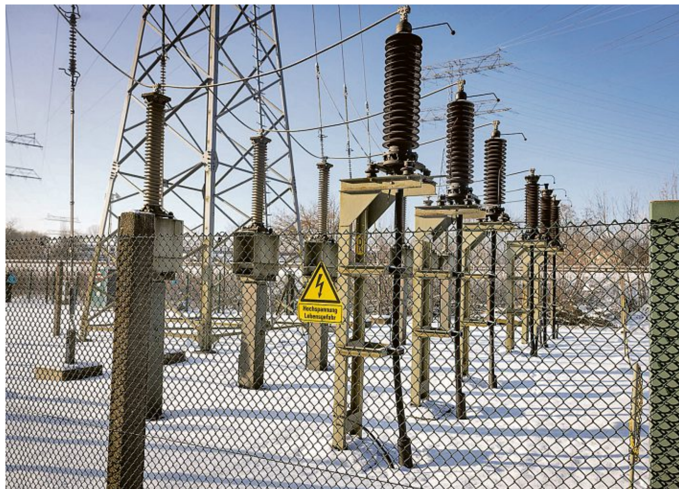
„Hochspannung Lebensgefahr“: Dieses Berliner Umspannwerk ist nur mit einem Zaun gesichert.
